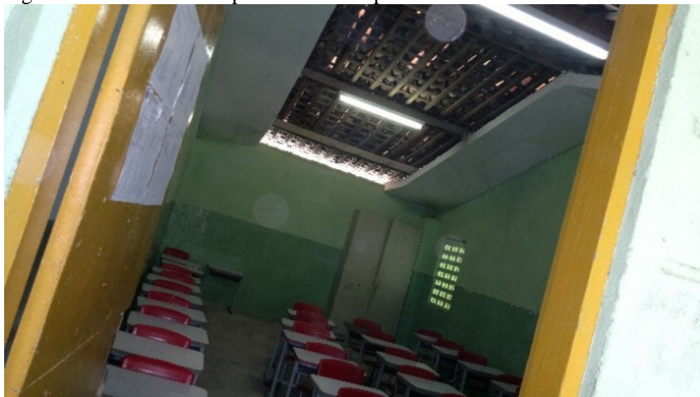
Figura 5 - Sala de aula improvisada entre pavilhões
