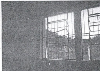
Janelas quebradas deixam a escola desprotegida
